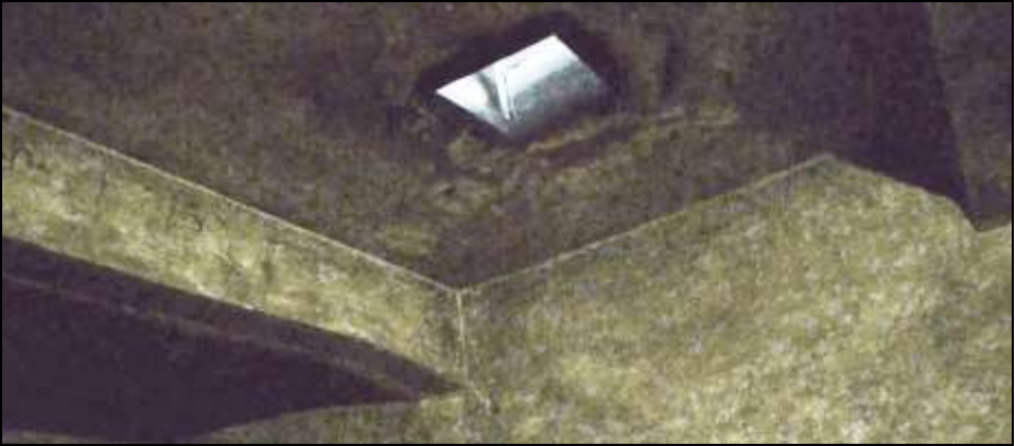
Abbildung 6: Foto eines Lochs nahe der ursprünglichen Trennwand und Tür.
